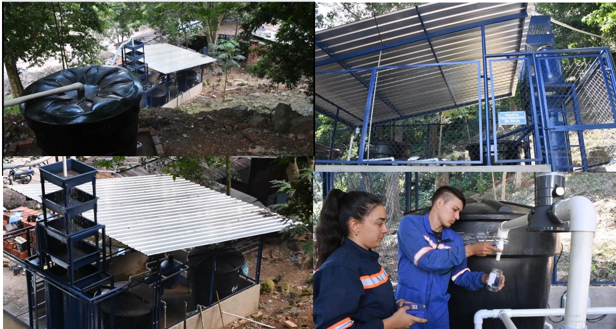
Planta De Tratamiento de Agua Potable
